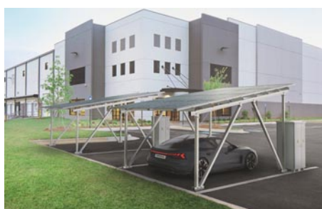
Der Solar-Carport versorgt einen Mittelklassewagen mit rund 17.000 Kilometer Reichweite im Jahr.
